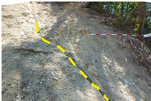
写真-10 滑落崖の直下で確認された侵食痕 ⑦
