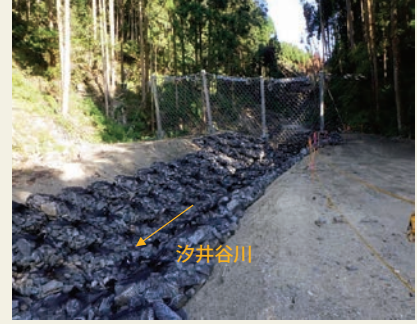
【H30.7月出水後の写真】
