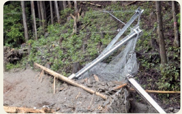
写真-2 支柱等の損傷事例
