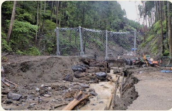
写真-1 導入後の河床低下事例
