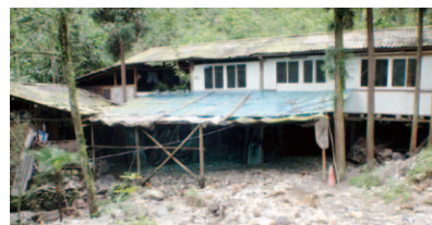
写真-3 1階が土砂で埋まった家屋
