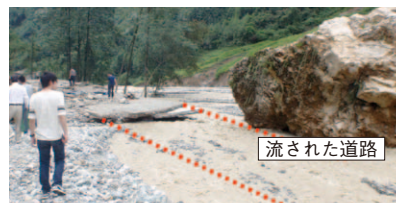
写真-2 深溪谷で寸断された道路
