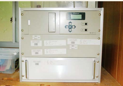
写真-1 水位信号変換器・安定器・記録計 (水晶式水位計) 5分間隔で水圧を水晶の振動数に変換
