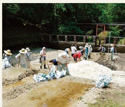
写真-10 堆積した土砂の排出作業 粒径の細かい砂で占められるため流水を利用して人力で容易に排出ができる。この作業の前後で水準測量により土砂の堆積量を測定している。全流出土砂量として記録される
