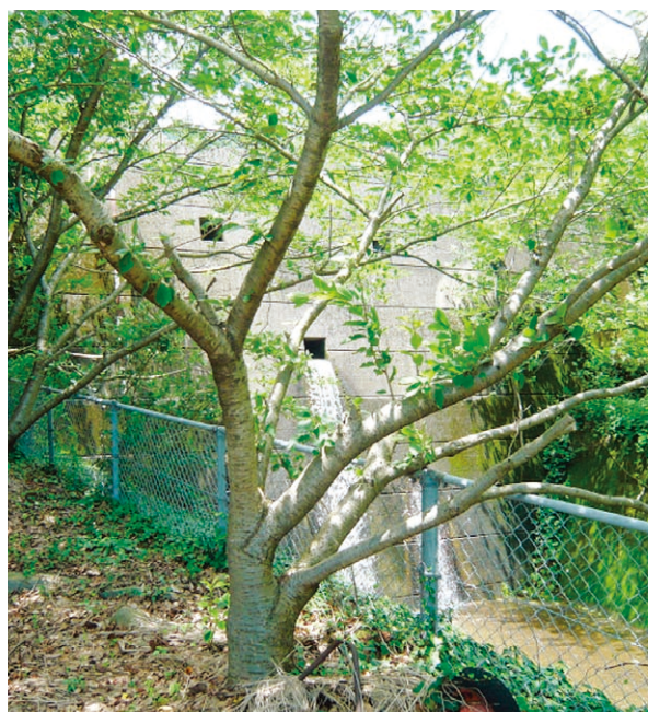
写真-7 2段目の水抜きからの流水
