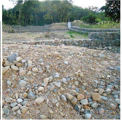
シンズリ道路(第1工区)沿いの砂防施設。施設の配置計画は日本人の砂防分野専門家の支援により行われた
