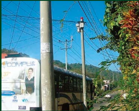
写真-12 エルサルバドル・サンタテクラ市斜面崩壊警報装置(電柱上に設置された赤色回転灯とスピーカー)
