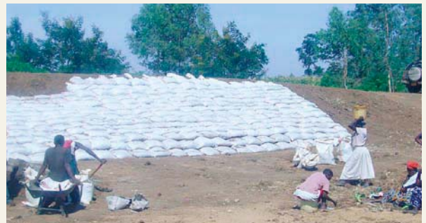
写真-15 ソイルセメントを詰めた土嚢による堤防工事(ケニア)
