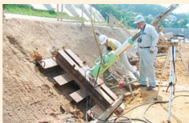
松江第五大橋道路南側側道法面工事 (基本調査試験立会：松江国道工事事務所)
