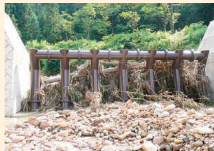
土石流を捕捉した事例 (平成20年7月28日北陸豪雨・富山県)
