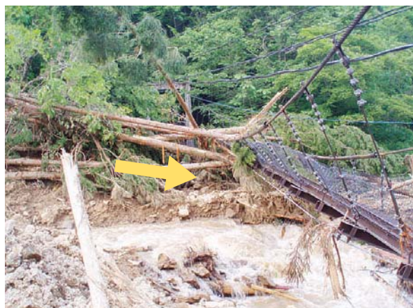
写真-7 行者の滝上流の土砂・流木堆積状況
