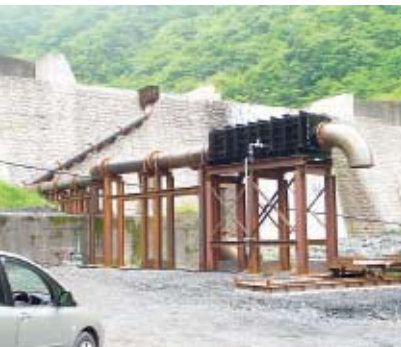
写真-1 全流砂量観測装置の全景
