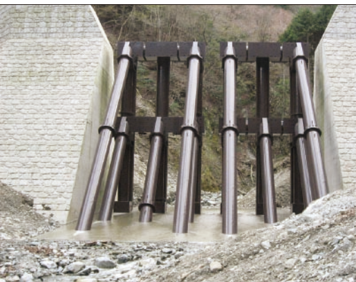
写真-7 I型スリット (神奈川県; 笹子屋沢砂防えん堤)
