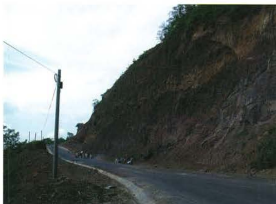
写真-14 2月の地震直後は、がけ崩れで道路が埋まっていたが、写真のように道路は復旧していた。法面工事は実施されていない。
