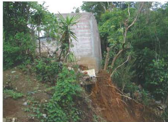
写真9 がけ崩れで被災した住宅。
