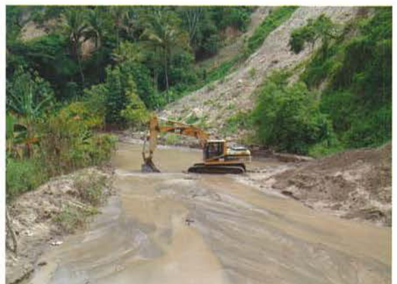
写真-13 河床上昇で洪水が発生しているとのこと。
