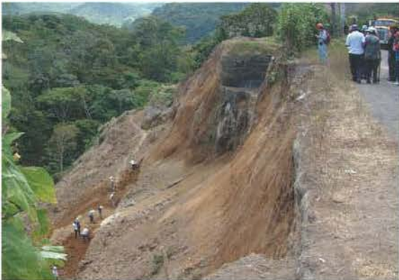
写真-22 1月13日の地震で発生した崩壊地の下部で崩壊の拡大防止工を実施しているところ (2月22日)
