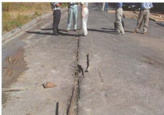
写真-7 道路の亀裂と写真右上が採取したボーリングコア (2月15日)
