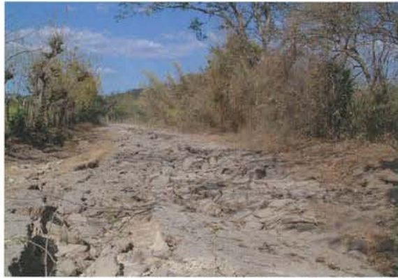
写真-18 2月13日の地震により損傷を受けた道路 (2月17日)
