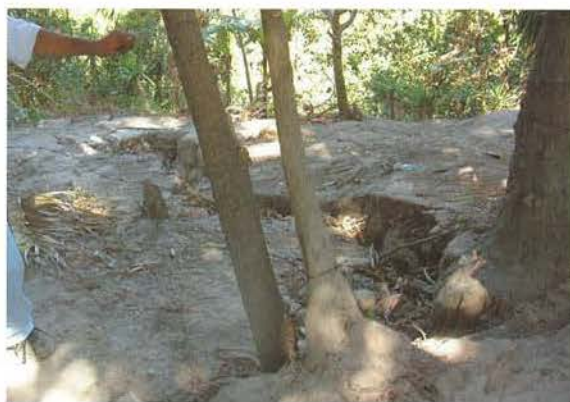
写真-6 地震による道路脇の亀裂 (2月15日)
