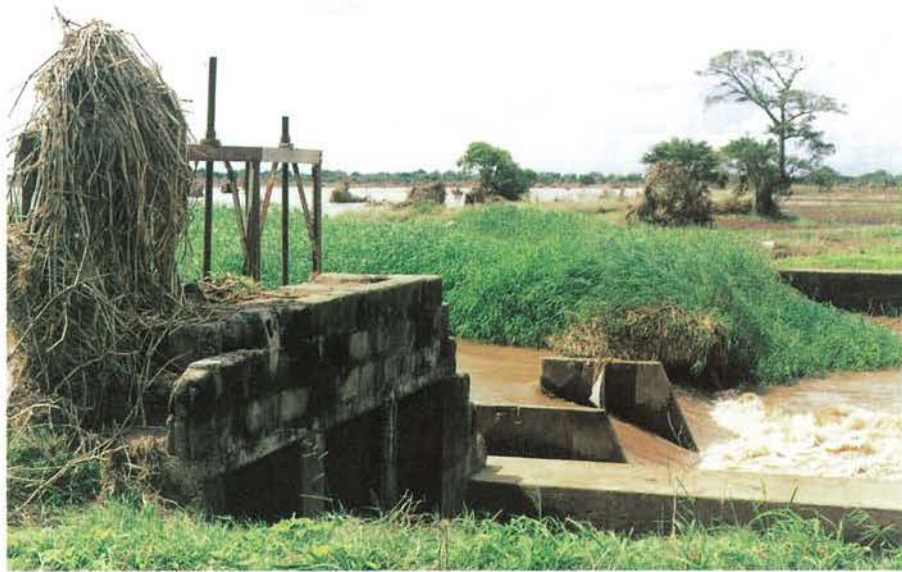
洪水で冠水した灌漑水路のゲート
