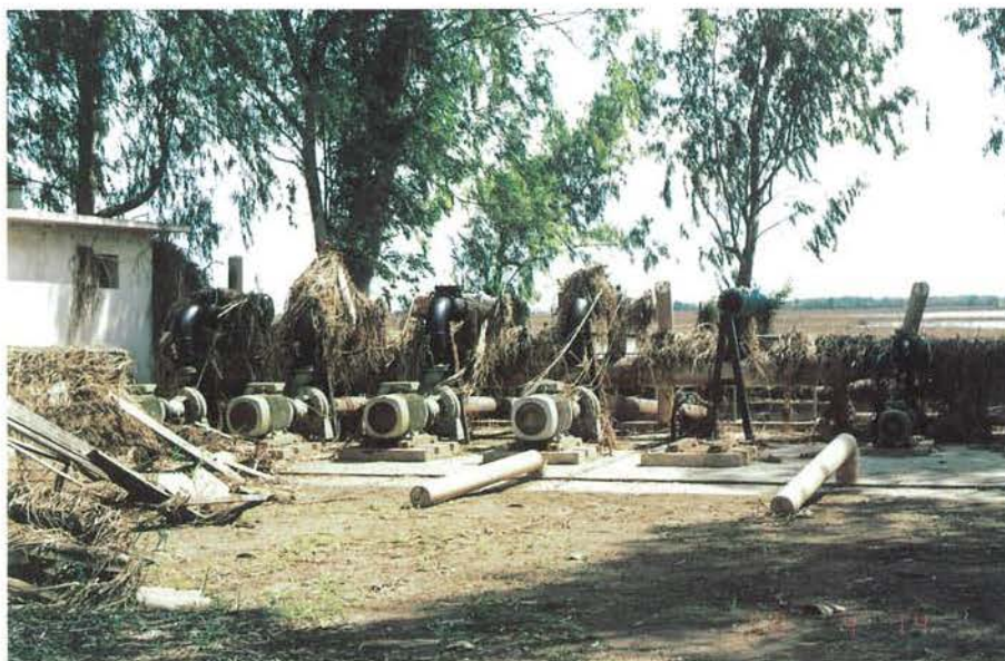
冠水して機能を失ったショクエの灌漑ポンプ場
