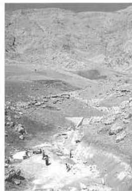
写真-12 写真に写っていないが手前にある道路を守るための砂防工事(道路に近い砂防ダムは練り石とし、上流で施工するものは空石又はギャビオンにしている)
