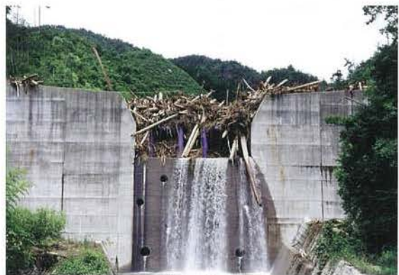
ダム下流から見た土石流発生後の様子
