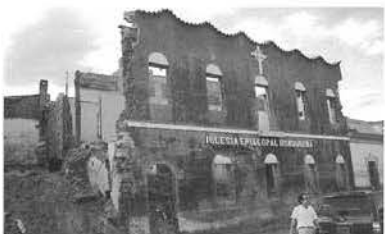
テグシガルパ市内中心部。アドベ（日干し煉瓦）でできた建物は融解した。原因は長期間の冠水である。
