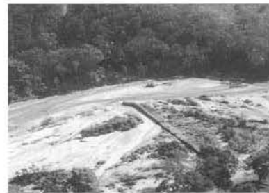
チョロマ川の川幅の拡大状況。ホンデュラス政府で建設したフトン籠床固めの左岸の袖抜けが生じた。
