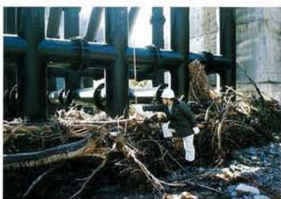
ダム最上流柱にたまった流木捕捉
