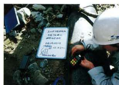
板厚測定浮き錆除去部
