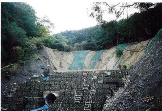
平山における崩壊状況 JR土讃線の盛土部が崩壊。
