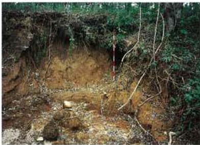
太陽の国 (からまつ荘) 背後の崩壊地 火山灰質土崩壊タイプで、泥流堆積物上位のローム層、スコリア層、軽石層が崩壊した。源頭部には湧水跡地形としてφ2mの穴が形成されている(ボールの背後)。斜面勾配は10°と緩傾斜である。
