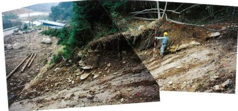
靉ノ目 (よしのめ) がけ崩れ 二次堆積物崩壊タイプで、溶結凝灰岩の上に巨礫まじりの崖錐堆積物が分布し、これが崩壊した。溶結凝灰岩の斜面勾配は27°である。崩壊土砂は斜面直下の人家2棟を直撃した。
