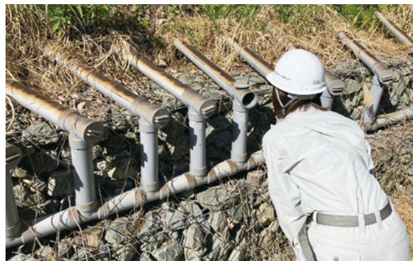
地すべり地内の排水状況を確認している様子。現地調査では、事前の準備をした上で、周りの方に質問しながら、自分の目で現場を見る力を養っていけたらと思います。(群馬県藤岡市譲原にて)
