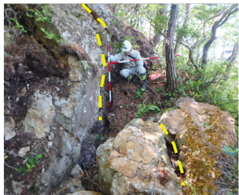
写真-9 ブロック側部で確認された亀裂 ⑥
