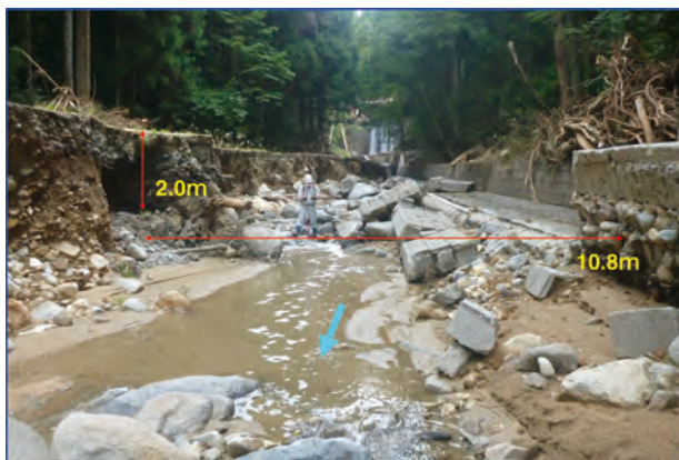
写真-5.1.2 渓流保全工（水路）の被災状況
