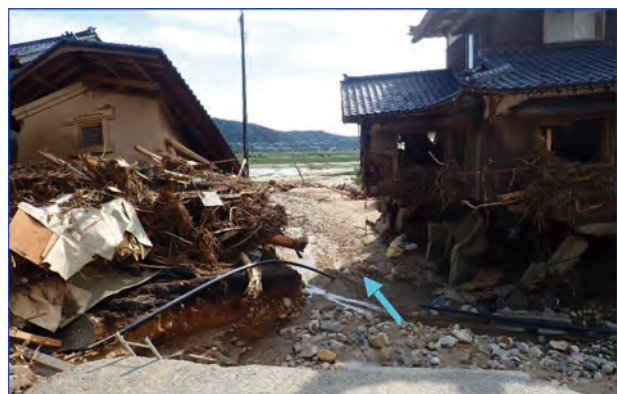
写真-5.1.4 左岸の民家の間を流下した後続流による侵食の状況
