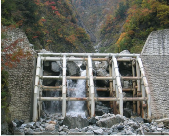
砂防堰堤（格子形） 南股第4号砂防堰堤 （松本砂防事務所管内；長野県北安曇郡白馬村）
