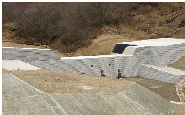
篠堂川8号砂防堰堤 (広島県北部建設事務所管内；広島県庄原市) ※砂防ソイルセメント施工便覧(平成28年版)より抜粋 峡谷において、人工地山とすることで袖部の掘削をなくし、コスト縮減・工期短縮・施工の安全性を確保した事例 (ここでは、人工地山に砂防ソイルセメントを用いた)
