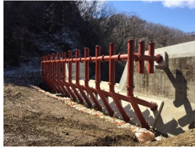
(二又沢上流第2砂防堰堤；利根川水系) (未満砂型)
