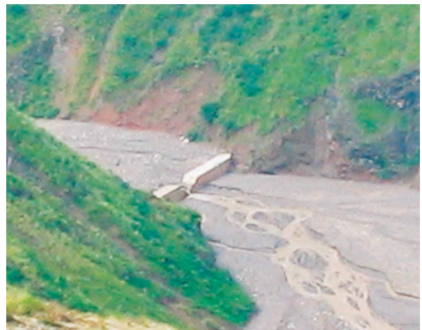
写真-1 小江本川上にある砂防堰堤の堆積状況
