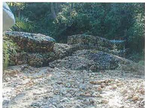
写真5 布団籠えん堤被災状況
