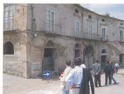
写真5 1998年災害時の土石流流下痕跡が残る住居
