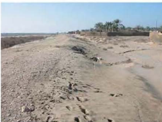
写真9 洪水から集落を守るための堤防 ● 越流してしまった (集落区間のみ建設。左側が川。イラン南部ブッシュェール州)
