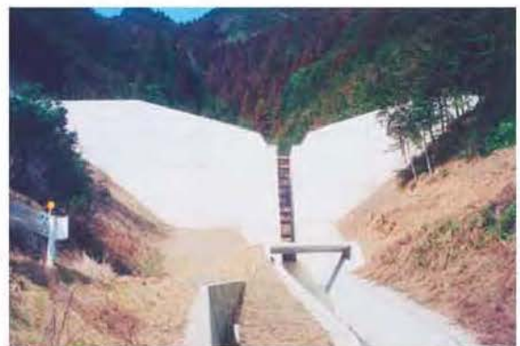
写真6 コンクリートスリット砂防えん堤に横材を設置した例
