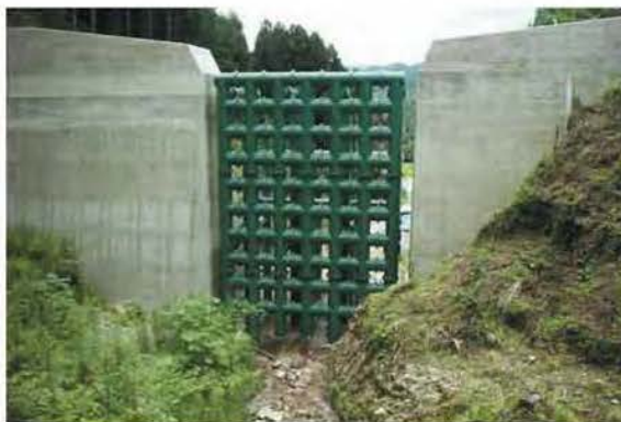
写真5 部材の目を細かくした鋼製透過型砂防えん堤の一例
