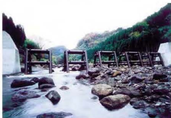
写真2 鋼製透過型砂防えん堤
