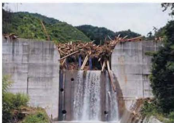
写真4 砂防えん堤に捕捉された大量の流木 荒谷川（広島市佐伯区）
