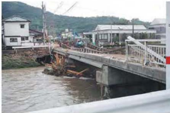
鶴田橋の崩壊（南福寺）
