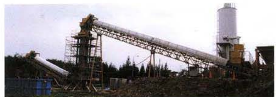
混合プラント（ロックラダー）※
