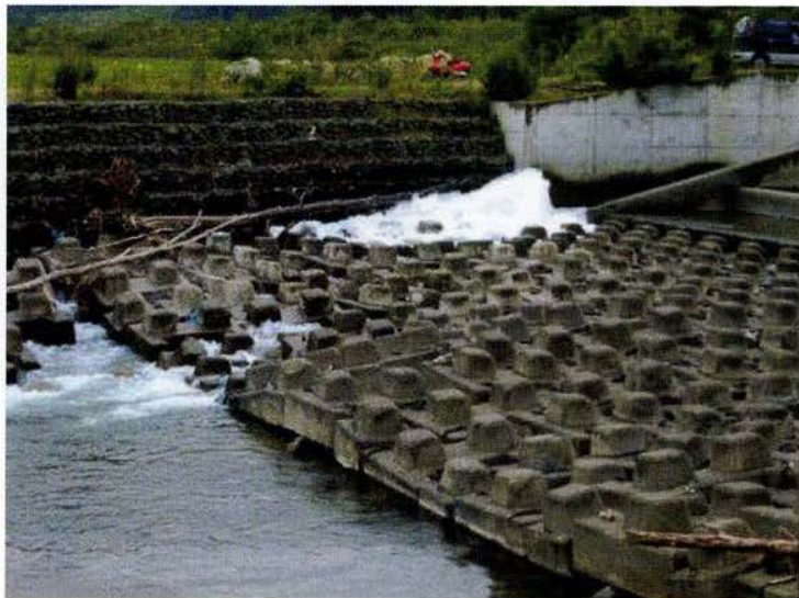
写真3 河床低下による魚道の浮き上がり。
