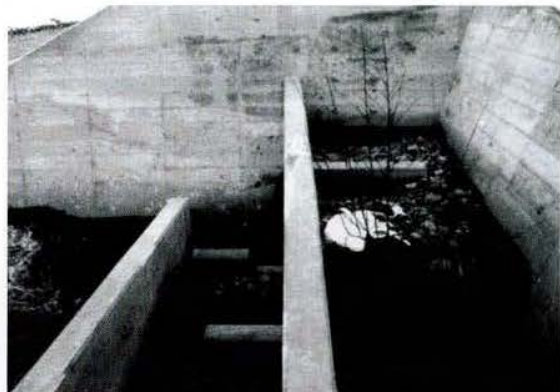
写真5 土砂がたまり、水の流れていない魚道。
