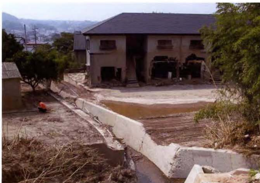
流路工の一部損壊と被災家屋の状況
