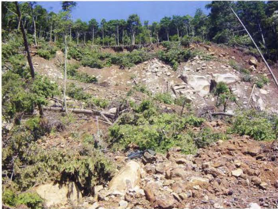
崩壊地上部の状況
