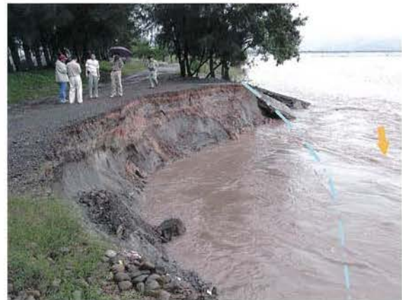
写真6 Bucac橋上流の護岸流失状況
