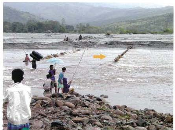
写真2 埋没した橋(ブカオ川)
