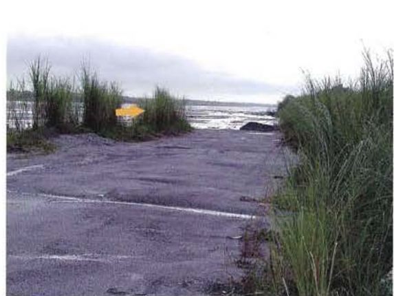
写真27 浸食により流失した河岸道路
