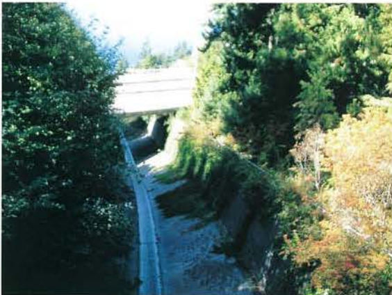
写真-5 Alberta Creekの導流工（流路工）。流路はコンクリートライニングが施されている。流路沿いには人家があるため警戒避難システムが整備されている。
