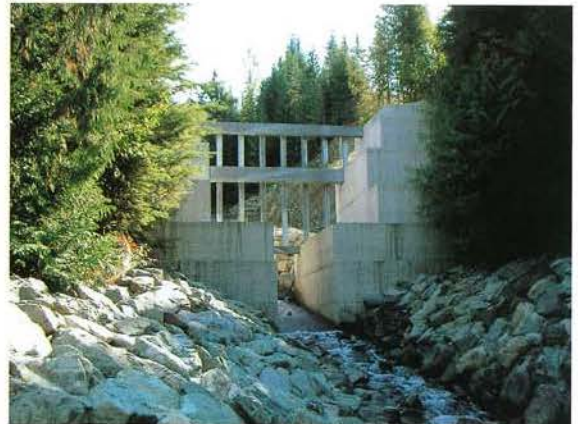
写真-9 Whistler Creekに設置された土石流捕捉施設（debris barrier）（上流のもの）。透過部は鋼製で、高さは12.5mである。
