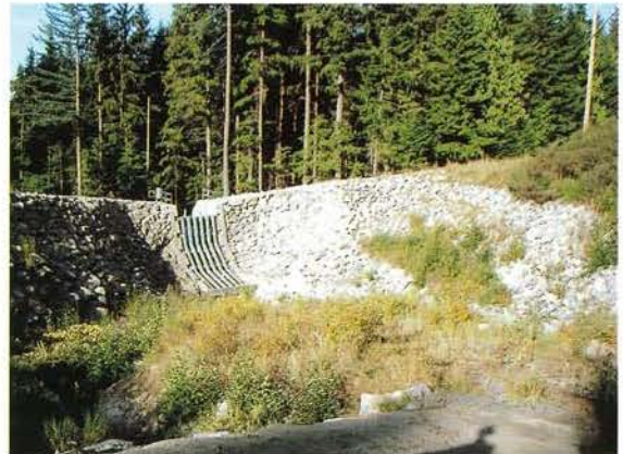
写真-1 Upper Mackey Creekの土石流捕捉施設（遊砂地+透過部（鋼製））。透過部の高さは12m、袖部の堤防の高さは2～12m。Highway99沿いではこのタイプの施設が多い。次のCharles Creekのものに比べて新しいため、構造も簡略化されている。
