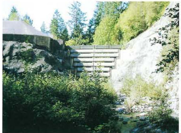
写真-6 Magnesia Creekの土石流捕捉施設（遊砂地+透過部（RC製））。透過部の高さは15mである。岩盤を掘削して遊砂地が作られた。透過部のRC梁は岩盤に接続している。
