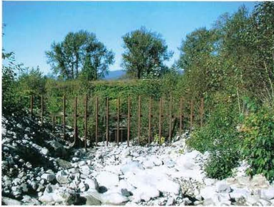
写真-12 Ted Creekの扇状地下流部。トランスカナダハイウェイを横切っているボックスカルバートの流木による閉塞を防止するために鉄道のレールを用いた流木止めが設置されている。
