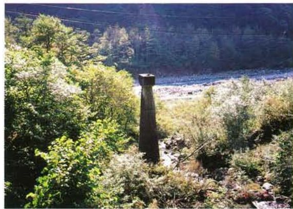
写真4 残された橋脚
